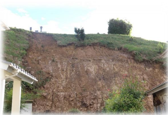
北長谷地内ではのり法面崩れが発生しました
