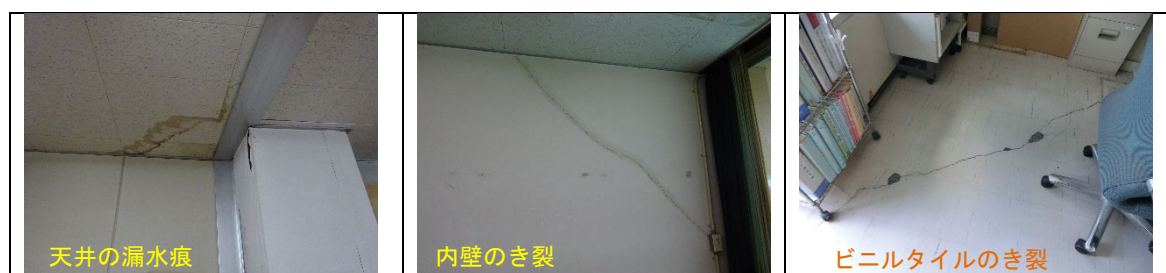
図表 29 : 内部仕上げの劣化状況
