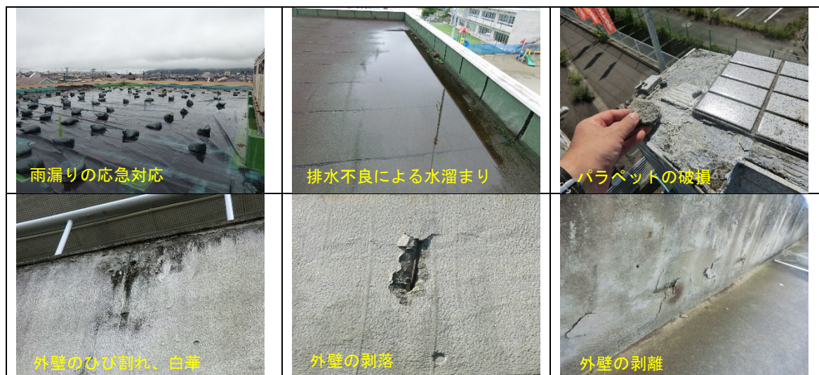
図表 27：外部仕上げの劣化状況
