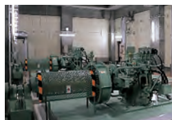
▲ポンプ場内部 (原動機室)
