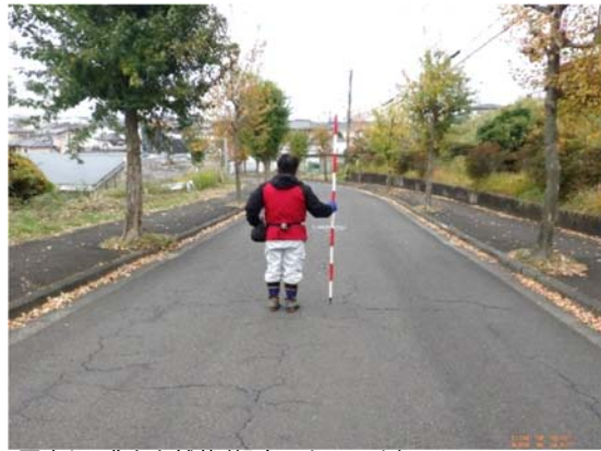
写真1 盛土上舗装(軽度のクラック)
