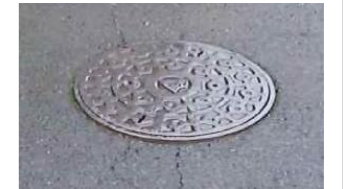
古いマンホール蓋
