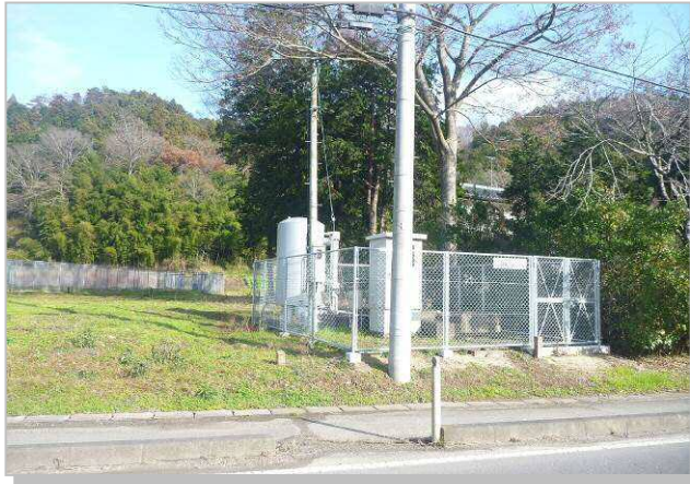
志賀第一ポンプ場
