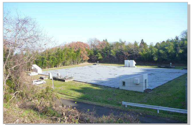
根方低区配水池
